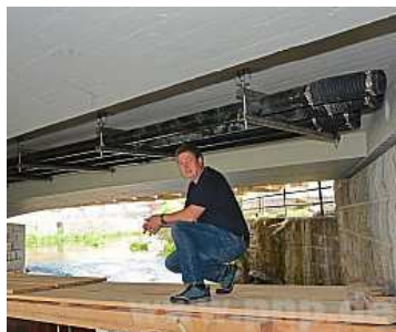
Die Arbeiten am Brückenunterbau sind bereits so gut wie abgeschlossen. Thomas Eiter vom städtischen Bauamt ist bislang sehr zufrieden mit dem Fortschritt auf der Baustelle.
