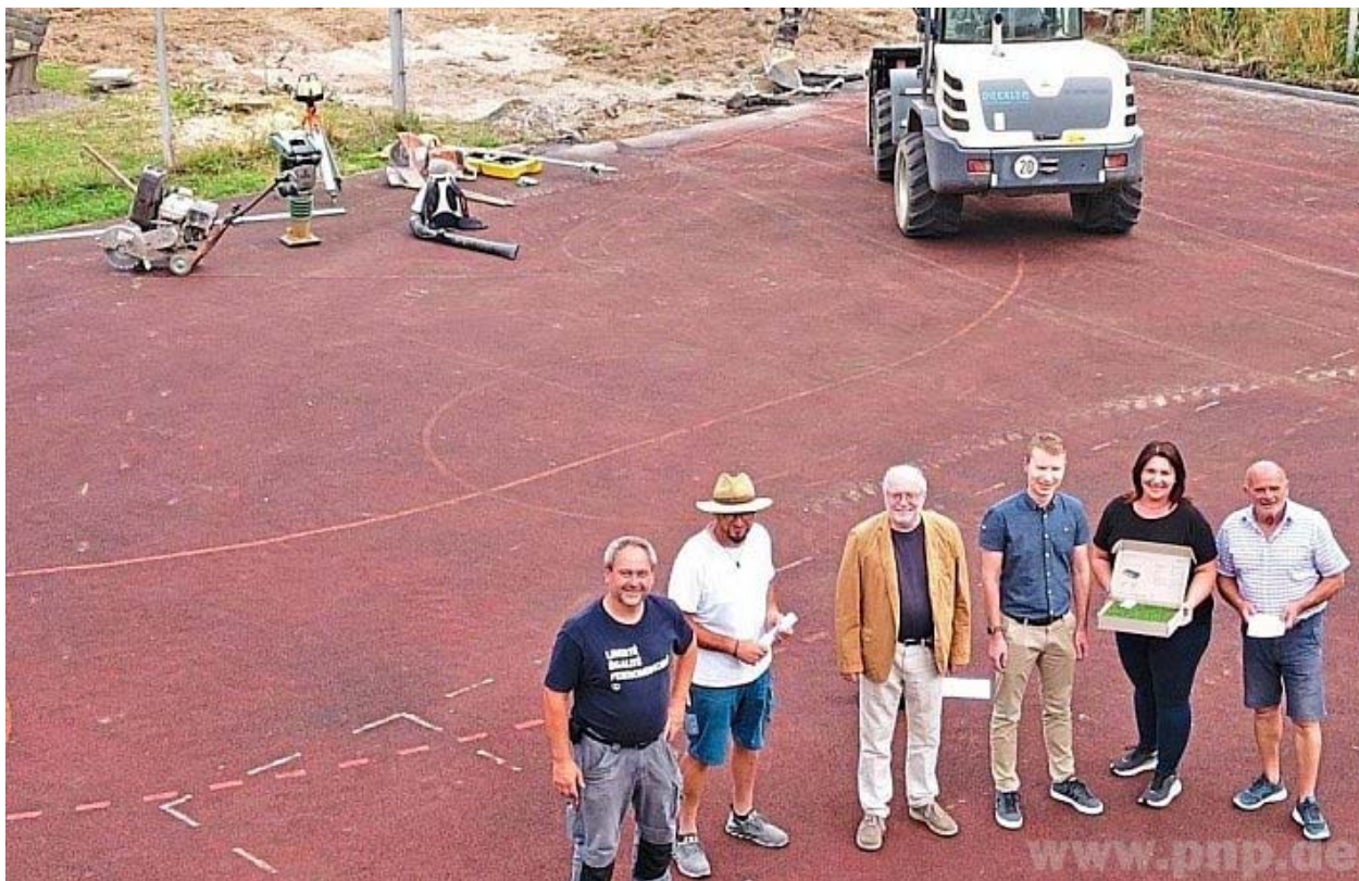
Sie wickeln die Erneuerung des Schulsportplatzes ab: (von links) Markus Kurz (Sportbeauftragter und Schulhausmeister), Franz Bachl (Projektleiter der Firma Drexler), Bernhard Schell (Schulleiter), Patrick Gaschler (stv. Geschäftsstellenleiter), Bürgermeisterin Simone Hilz und Hans Kopp (Projektleiter Kiendl & Moosbauer). –Foto: Birnböck
